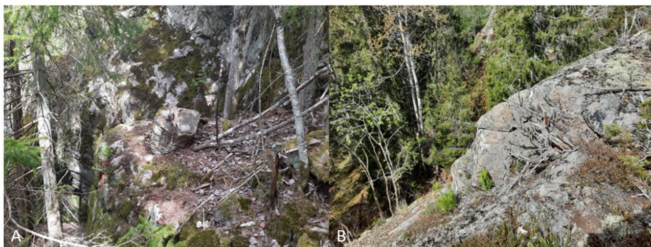
Figur 7 A: Relativt tungt blockfall. B: Löst stenblock vid krönet.
