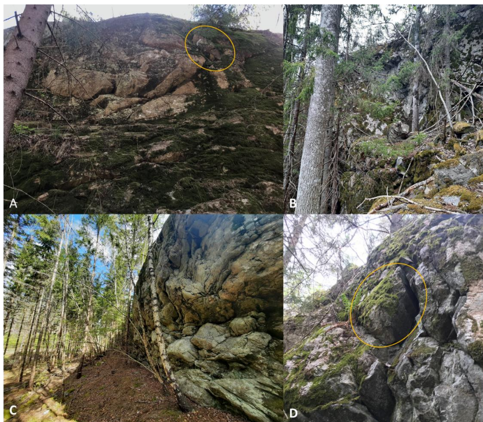
Figur 4. Plats A: Potentiellt löst block (markerat i gul). Plats B: Växande träd i berget. Plats C: Överhäng. Plats D: Ytvittrat berg med potentiellt löst block.
