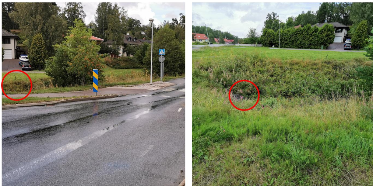
Figur 3-9 TV: Krondike i förhållande till övergångsställe i norra delen av Nibblevägen. TH: Foto ned mot krondiket med mycket vegetation med stor kulvert i botten, uppskattad till en dimension på 1600 mm.
