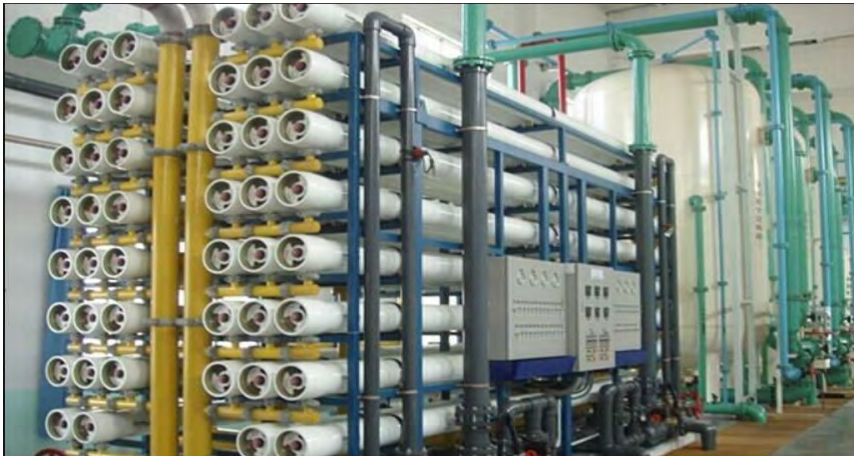
Figur 9. Omvänd osmosmembran filteranläggning.
