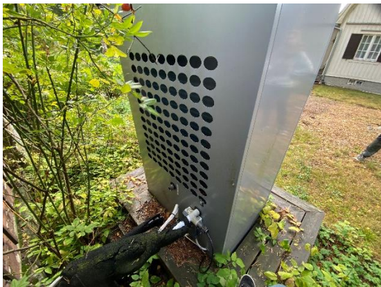
Bild 19 - Luft/vattenvärmepump trasig. Byts ut.
