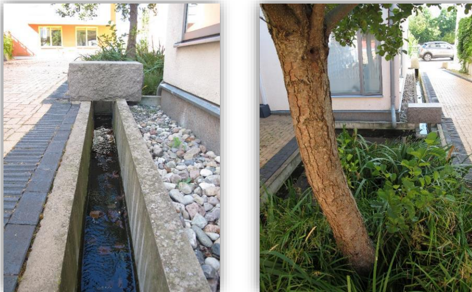
Bild 10. Exempel på dagvattenränna som transporterar dagvatten längs en husfasad. Dagvattenrännan avleder vatten från en anlagd regnbädd, både från regnbäddens dräneringsledning och vid höga vattennivåer. (Foto: Tyréns AB, från kv. Bo01, Malmö)
