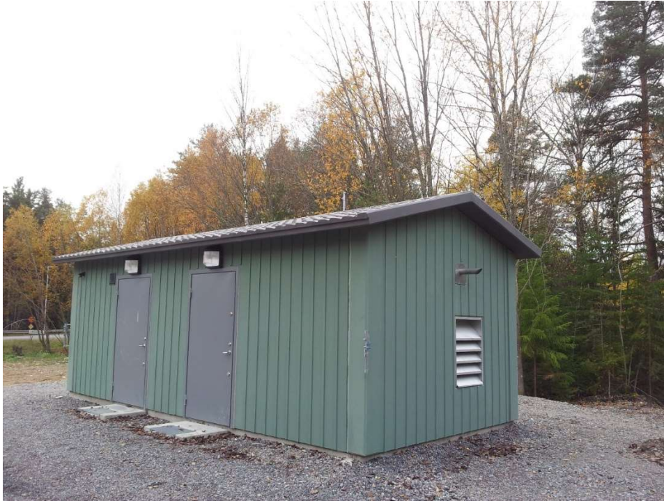
Bild 6 . Avloppspumpstation med överbyggnad och reservkraft (Botkyrka kommun).
