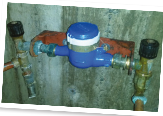
Vattenmätare med LK580-ventiler som inte längre är godkända.
