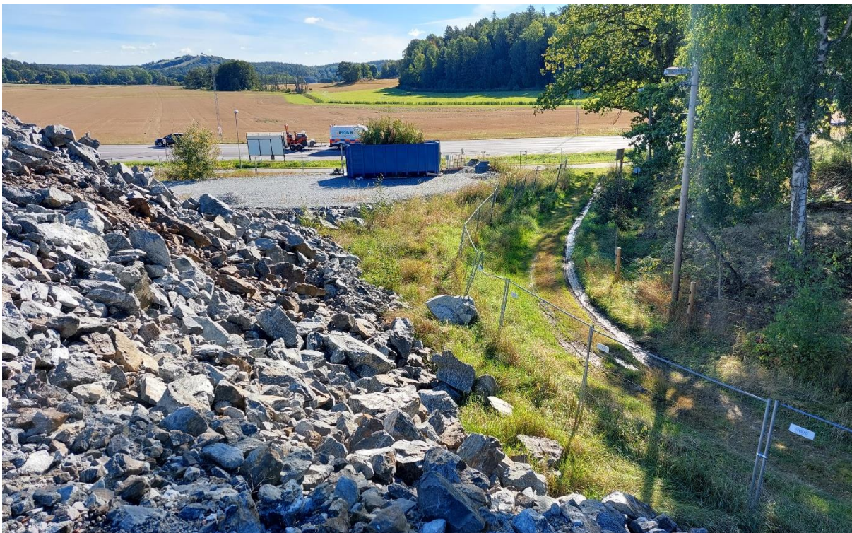
Figur 3-5. Sydöstra utkanten av fastigheten där svackdiket leds ut mot Hågelbyvägen. Fotografi taget i östlig riktning. I bild syns container som renar dagvatten från kväve.
